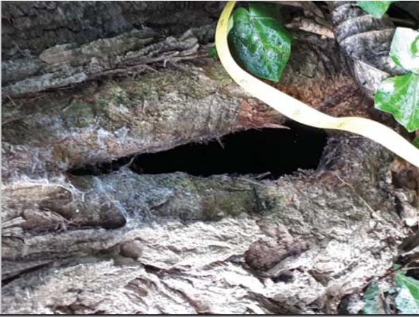
ouverture cavité au pied de l'arbre
